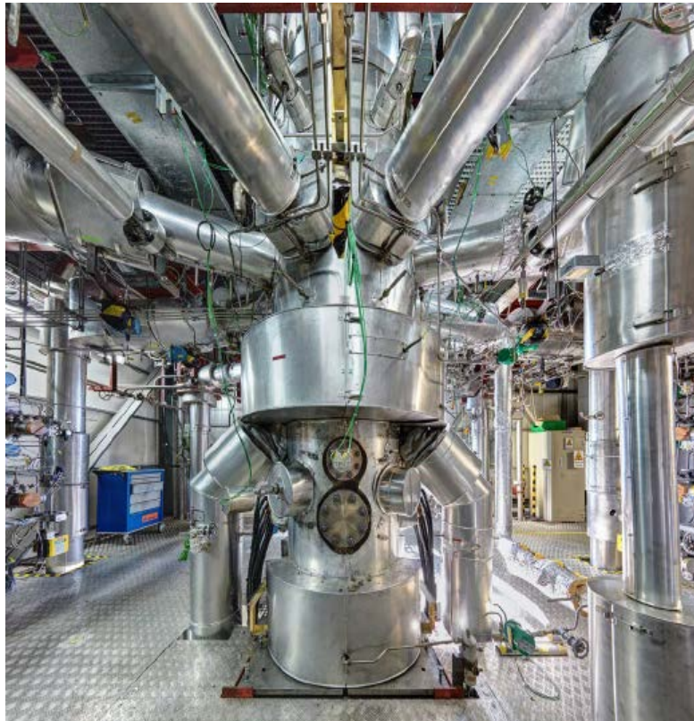
Reaktordruckbehälter mit Hauptkühlmittelleitungen der PKL (Primärkreislauf)-Versuchsanlage der Framatome GmbH
